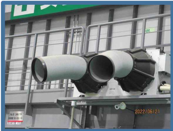
ゾーン空調（工場全体を冷やします）
